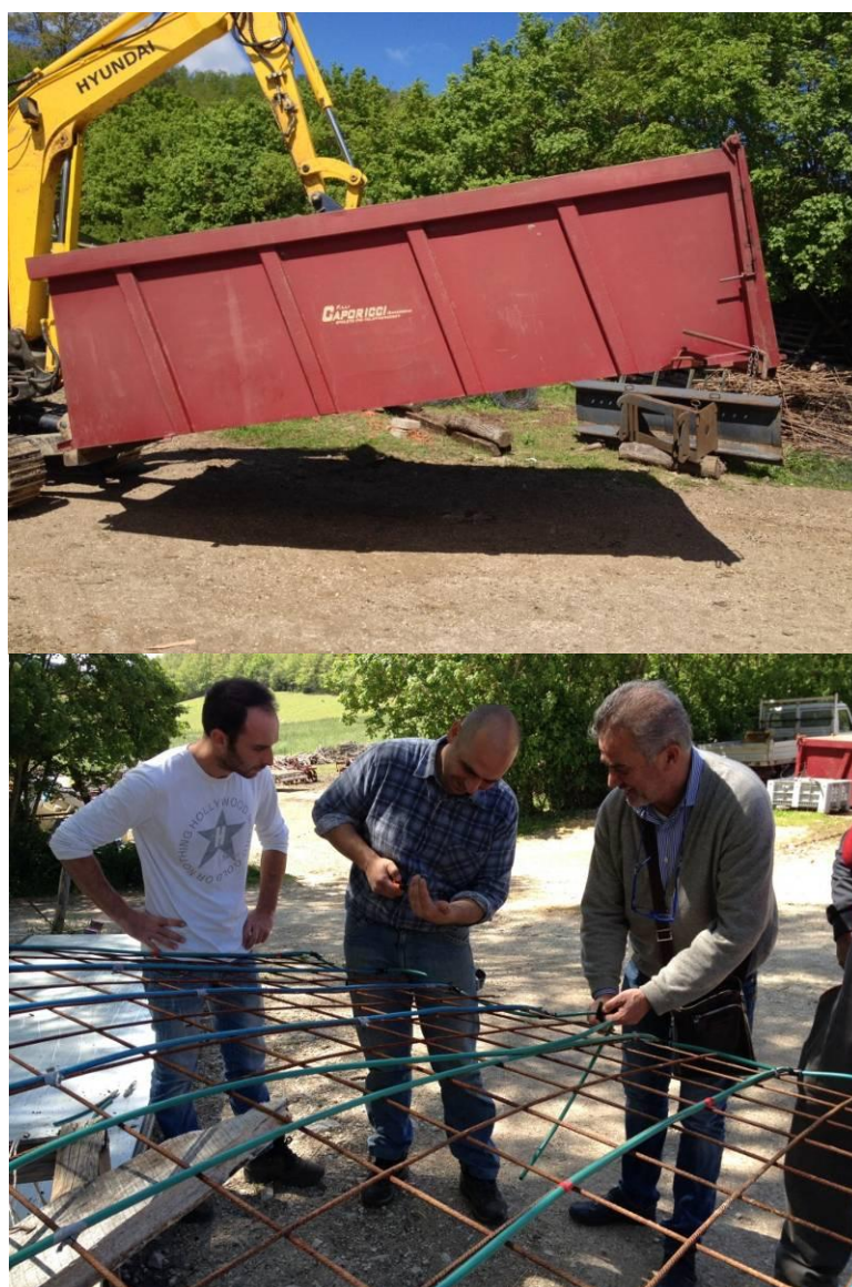
Foto 3.4: biocontainer e particolare della predisposizione delle tubazioni per la distribuzione dell'aria.
