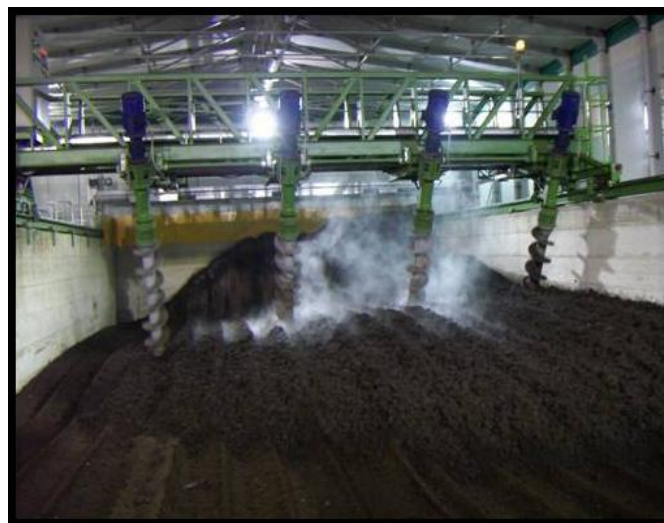
Figura 1.3: trincee dinamica areata con macchina rivoltatrice costituita da coclee inclinate verticali
